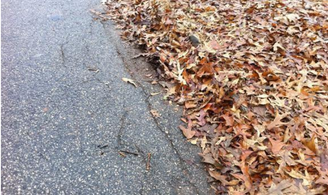
Fig. Edge Cracks
