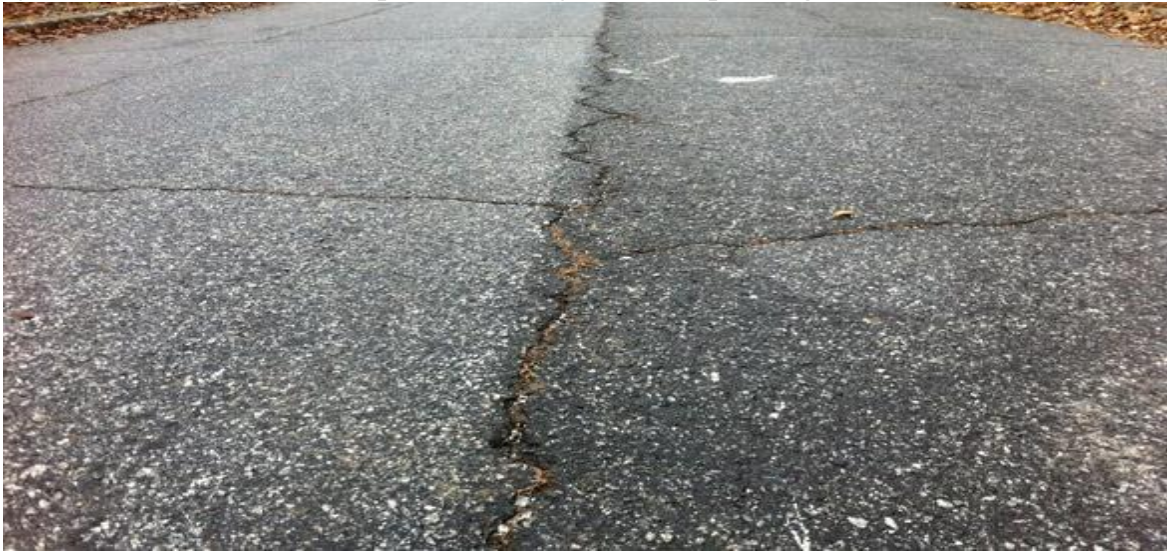
Longitudinal (Linear) Cracking
