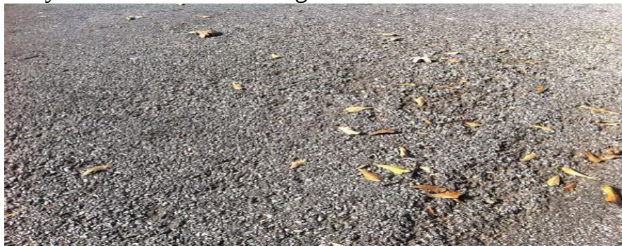
Fig. Raveling (very porous asphalt)
