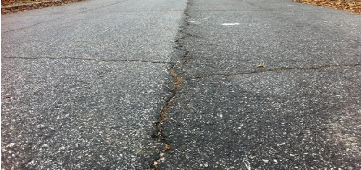
Longitudinal (Linear) Cracking
