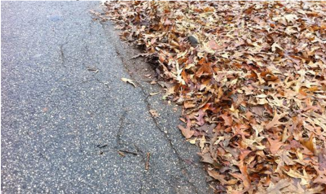
Fig. Edge Cracks
