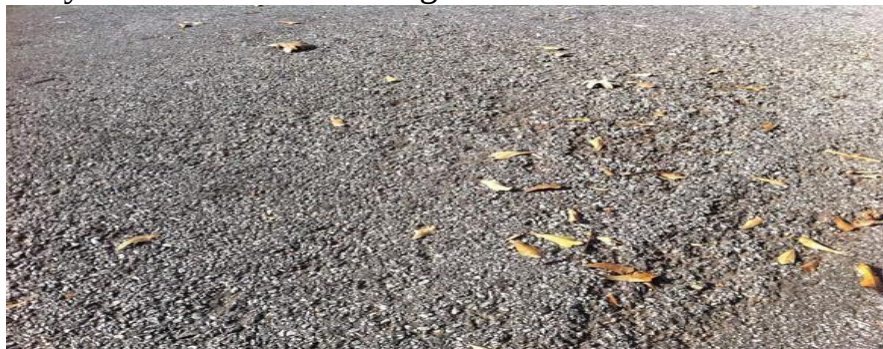
Fig. Raveling (very porous asphalt)
